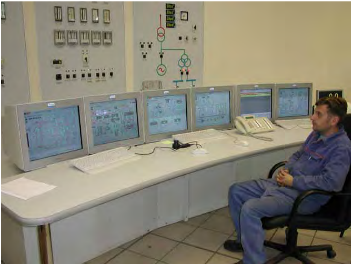
Рис. 4. Блочный щит управления Новосибирской ТЭЦ-5.
