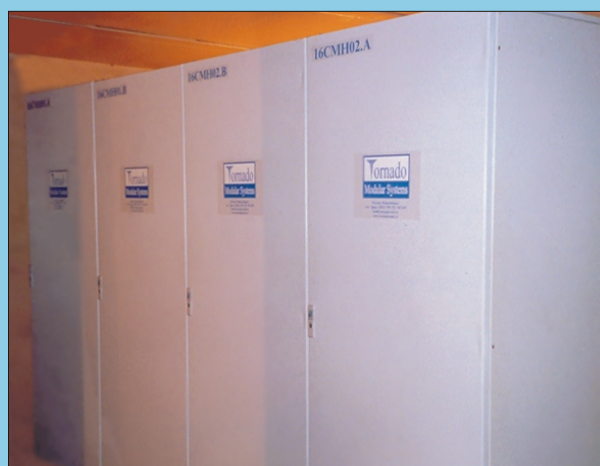
Шкафы контроллеров котлоагрегата на объекте
