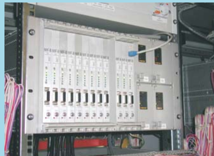
Крейт MIF-контроллера в шкафу КФУ
